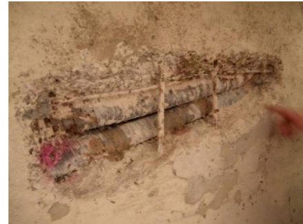
Détails de corrosion
