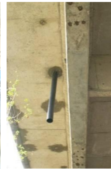
Situation après inhibition de la corrosion sur toute la longueur des câbles et réparation de béton. Les travées d'approche ont été remplacées en 2023. Une « autopsie » par sciage a permis de constater le succès de la méthode. (Voir plus loin)
