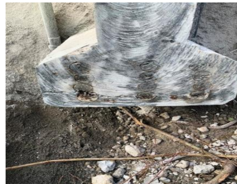
Coupe dans la section centrale : Aucune reprise de corrosion
