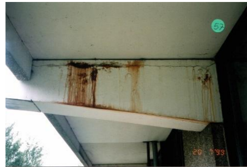
Avant travaux : Armatures principales des consoles corrodées par chlorure ajouté au béton
