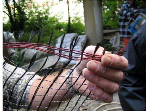
Treillis protection cathodique
