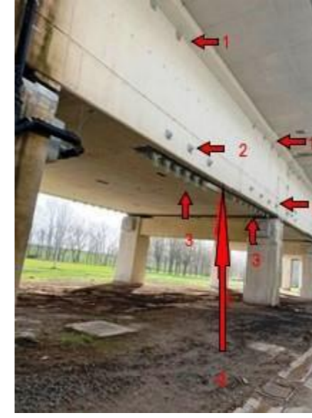
Détail des renforcements structurels des chemins de roulement par barres de précontrainte forcées et par plats collés d'acier
