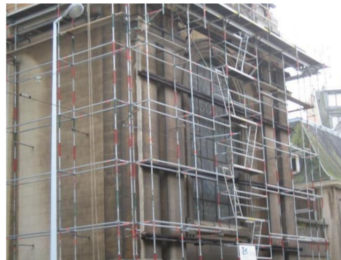
Transept stabilisé par ancrages sans utilité réelle
