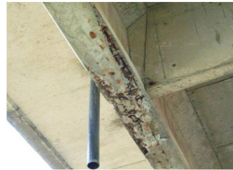
Corrosion des câbles inférieurs à mi-portée
