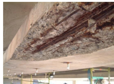
Désordre de corrosion
